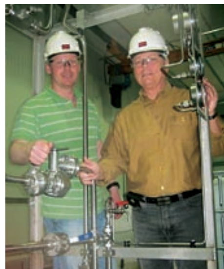
Husveg og Sivertsen viser frem deler av ventilen.
